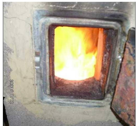
Russbrand in oberer Reinigungsöffnung erkennbar
